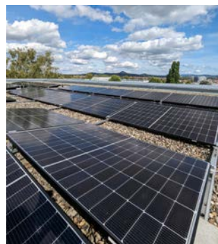
Photovoltaikanlage auf dem Dach des Beruflichen Schulzentrums Göppingen
